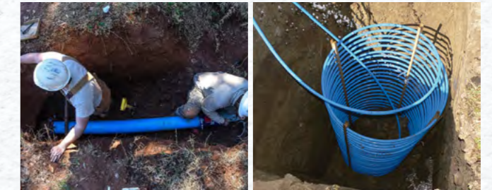
Boucle et corbeille géothermique
